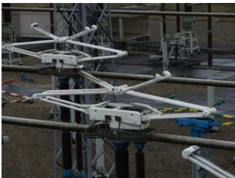
Schade aan railscheider A
